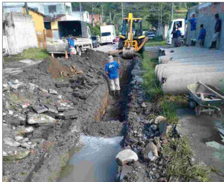
FIGURA 26 – TROCA DE TUBULAÇÃO EM REDE DE DRENAGEM, CARAGUATATUBA - SP FONTE: PREFEITURA MUNICIPAL DE CARAGUATATUBA, 2024.
