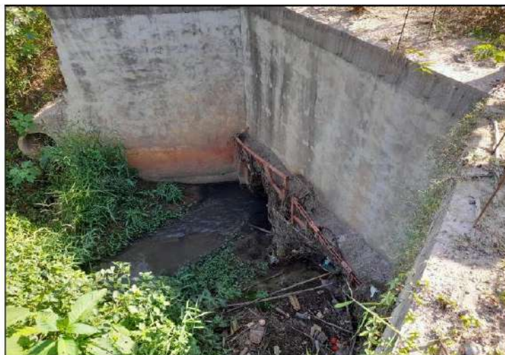
Figura 25 – Embocadura do bueiro sob a Dutra com dois tubos de 2,0 m de diâmetro. Observar que o da direita apresenta-se obstruído
