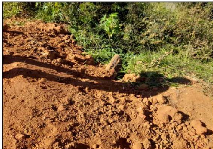
Figura 15 – “Saia” do talude. Material solto e com alguns restos de troncos aparecendo
