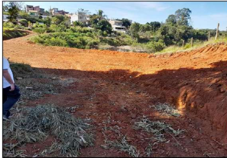
Figura 10 – Vista do maciço e da movimentação de terra a partir da margem esquerda
