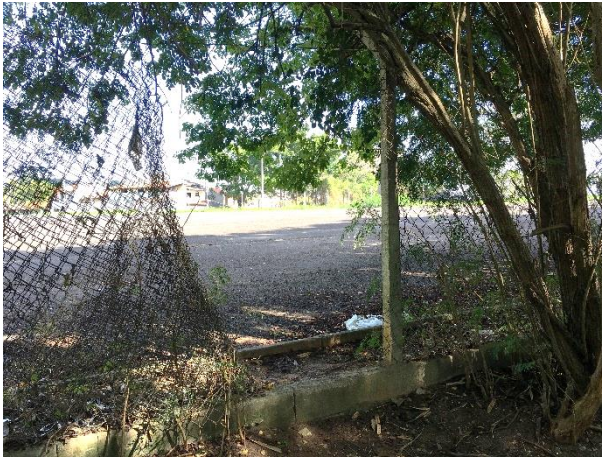
FIGURA 143 – GRADIL DANIFICADO FONTE: ACERVO DO AUTOR, 2022
