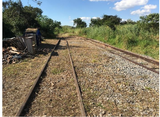
FIGURA 135 – DISPOSIÇÃO INADEQUADA DE RESÍDUOS DA CONSTRUÇÃO CIVIL FONTE: ACERVO DO AUTOR, 2022
