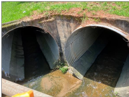
FIGURA 4 – TUBULAÇÃO EM AÇO CORRUGADO, AV. ANTÔNIO GARCIA DA CUNHA, TAUBATÉ-SP FONTE: ACERVO DO AUTOR, 2023.
