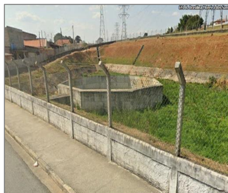
FIGURA 9 – RESERVATÓRIO DE CONTENÇÃO, RUA BRASILINA MOREIRA DOS SANTOS, TAUBATÉ-SP FONTE: GOOGLE EARTH, 2023.
