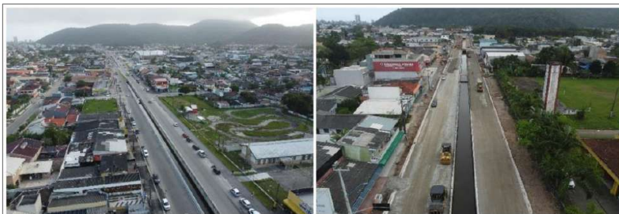
FIGURA 22 – CANALIZAÇÃO E DUPLICAÇÃO DA AVENIDA JK, MATINHO - PR. FONTE: AGÊNCIA ESTADUAL DE NOTÍCIAS, PARANÁ, 2024.
