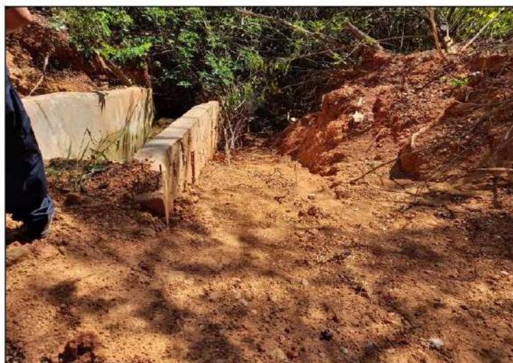
Figura 19 – Lateral direita da estrutura de saída. Forte inclinação e material solto propício à erosão e risco de dano à estrutura
