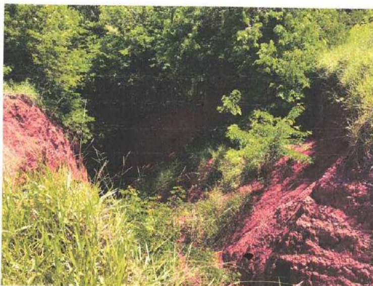
Foto nº 7: Vista do processo erosivo desencadeado no final da "vala";
