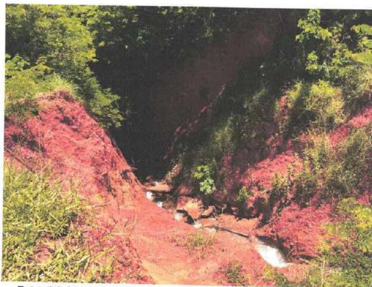
Foto nº 8: Vista do processo erosivo desencadeado no final da "vala";
