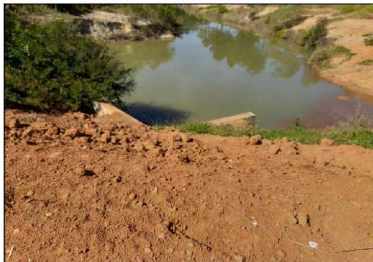
Figura 16 – Estrutura de emboque do bueiro. Muros de aproximação a 120°. Observar material solto no talude
