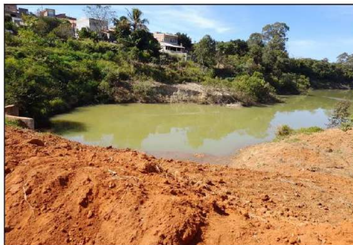
Figura 11 – Situação atual do lago. Observar a margem direita, composto de solo arenoso, em processo de desbarrancamento
