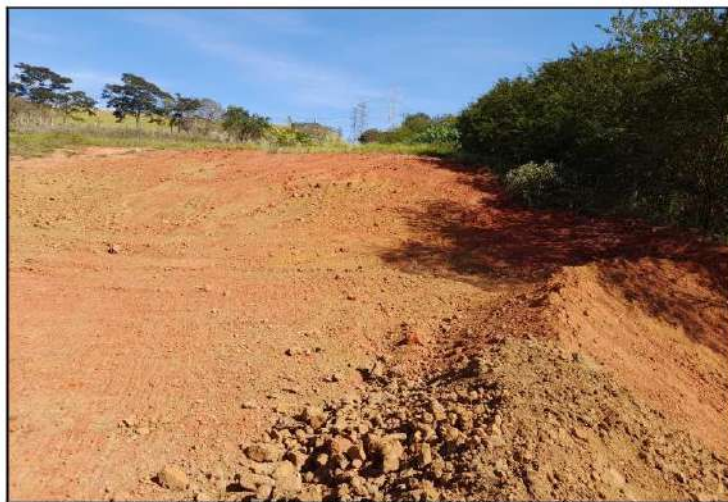
Figura 14 – Vista do centro do maciço para a margem esquerda. Observar o talude com material solto no lado direito da foto
