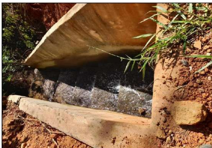
Figura 18 – Saída do bueiro com dissipador em degraus
