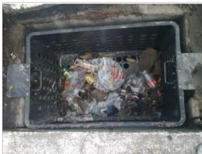
FIGURA 6 – FILTRO DE RESÍDUOS EM BOCA DE LOBO FONTE: SISTEMA DE ÁGUA, ESGOTO E SANEAMENTO AMBIENTAL DE SÃO CAETANO DO SUL, SÃO PAULO, 2022.
