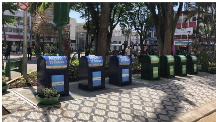
FIGURA 5 – LIXEIRAS COM SISTEMA SUBTERRÂNEO NA PRAÇA DOM EPAMINONDAS, TAUBATÉ-SP FONTE: PORTAL R3, 2019.
