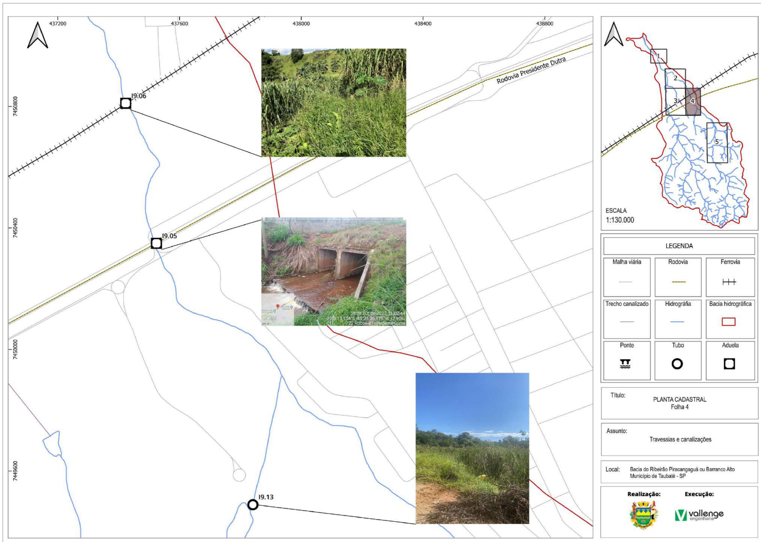
FIGURA 56 – PONTOS DE INTERFERÊNCIA EM TRAVESSIAS E CANALIZAÇÕES DA BACIA HIDROGRÁFICA 09 - RIBEIRÃO PIRACANGAGUÁ OU BARRANCO ALTO (FOLHA 4) FONTE: ELABORADO PELO AUTOR, 2024.
