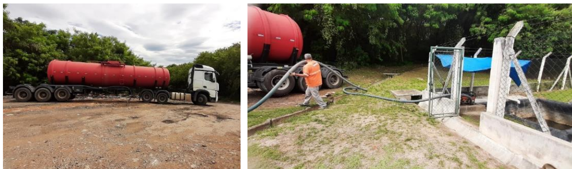
Figura 135: Caminhão tanque que coleta o efluente armazenado na lagoa.
