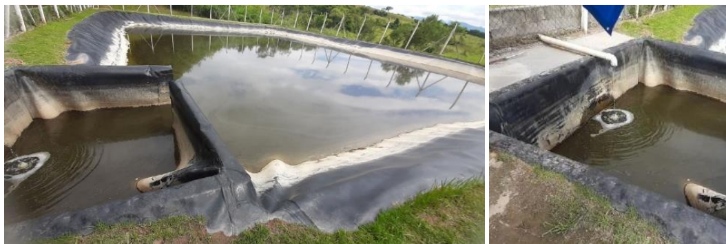
Figura 134: Lagoa de armazenamento de chorume.
