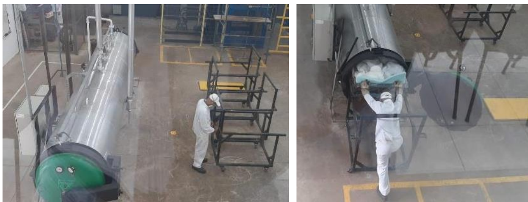
Figura 122: Vista da autoclave - UTRSS.
