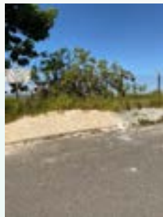
FIGURA 157 - DISPOSIÇÃO INADEQUADA DE RESÍDUOS DA CONSTRUÇÃO CIVIL FONTE: ACERVO DO AUTOR, 2022
