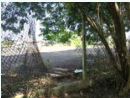
FIGURA 160 – GRADIL DANIFICADO FONTE: ACERVO DO AUTOR, 2022
