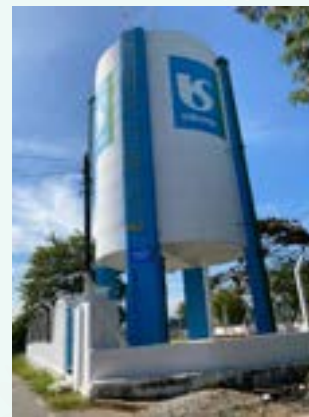
FIGURA 155 – RESERVATÓRIO DE ÁGUA TRATADA FONTE: ACERVO DO AUTOR, 2022
