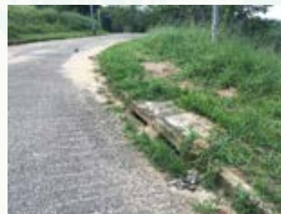
FIGURA 122 - BOCA DE LOBO FONTE: ACERVO DO AUTOR, 2022
