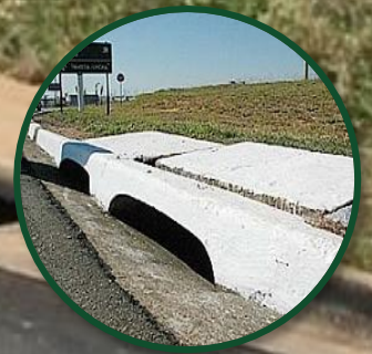
Boca de Lobo
