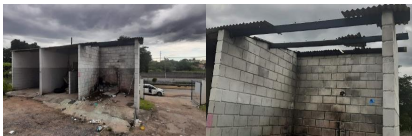
Figura 166: Baias para armazenamento de materiais - PEV Parque Aeroporto.
