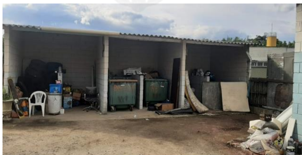
Figura 183: Baías de armazenamento de resíduos – PEV Mantiqueira.
