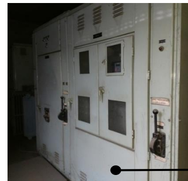
Cabine primária obsoleta
