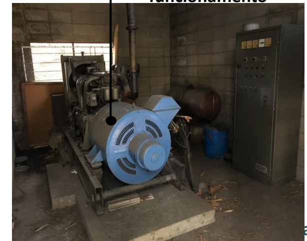
Gerador apresenta falhas no funcionamento
