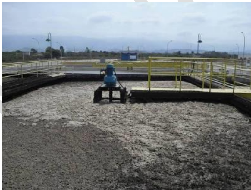
Figura 6.2.4-4. Tanque de aeração com sistema de injeção de oxigênio puro.
