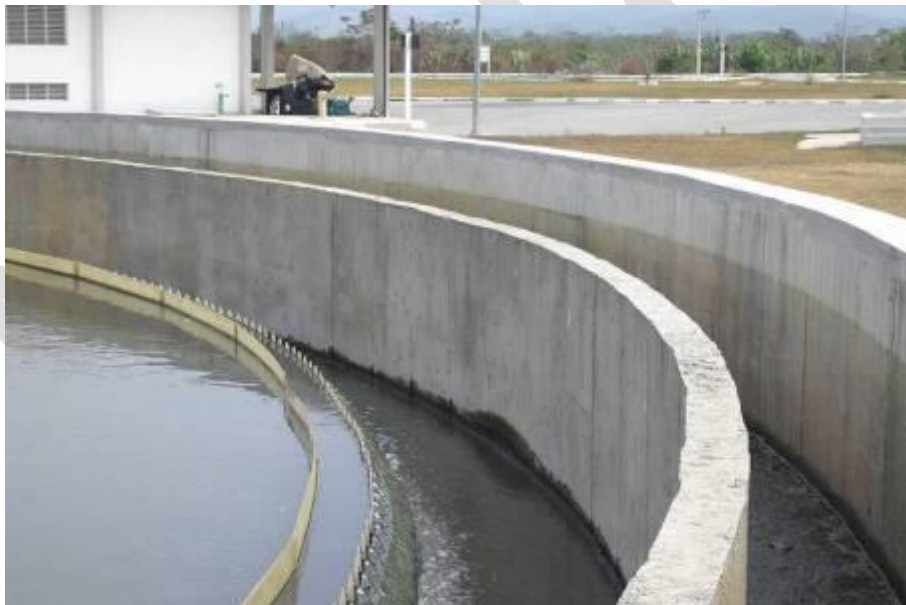
Figura 6.2.4-6. Canaleta de coleta do efluente do decantador.
